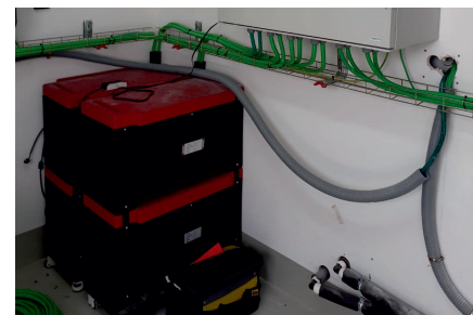
Electrofil Oeste Distribución
